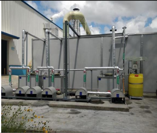
污水处理站臭气处理设备（现有）
