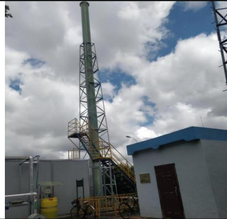
污水处理站废气排气筒及采样平台（现有）
